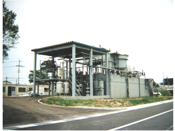
排水の高度処理システム
